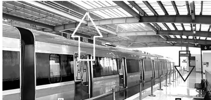
Nhà ga Yên Nghĩa mưa dột gần 8 tháng (ẢNH: TIENPHONG.VN)
