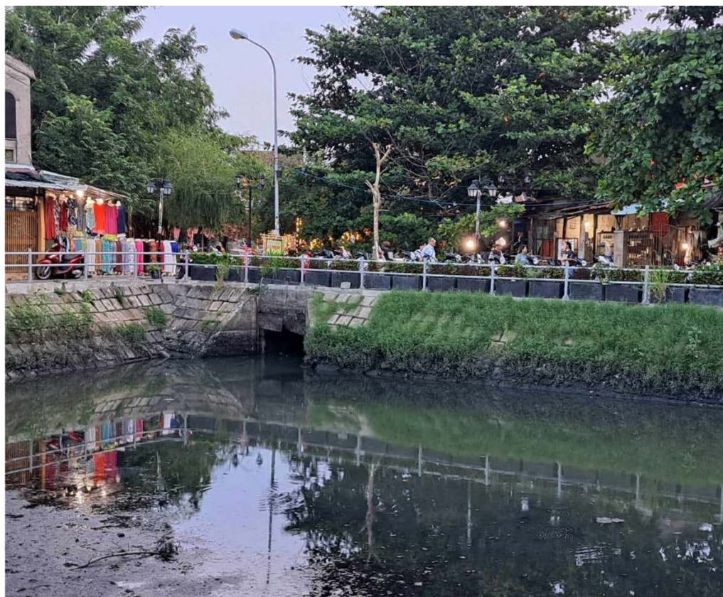
Hồ điều hòa cần được nạo vét bùn, rác.
