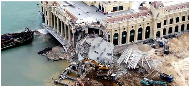
Ga cáp treo đang xây dựng tại khu vực cảng Nha Trang đổ sập phần tháp chuông. (ẢNH: BUI TOAN/VNEXPRESS.NET)
